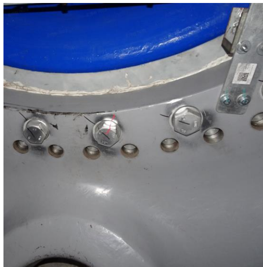
图 15-14 螺纹孔裸露部分
