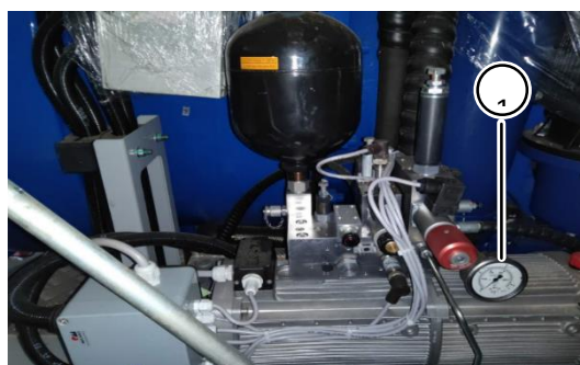
图 9-4 高速轴刹车液压站
